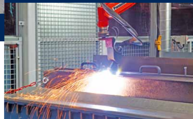
Der neue vollautomatische Plasma-Brennroboter
